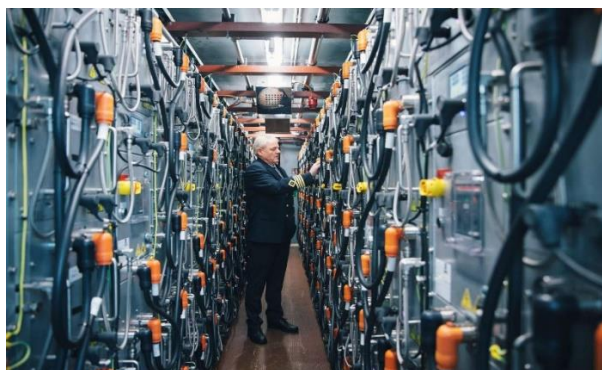
شکل ۲- اتاق باتری در کشتی
